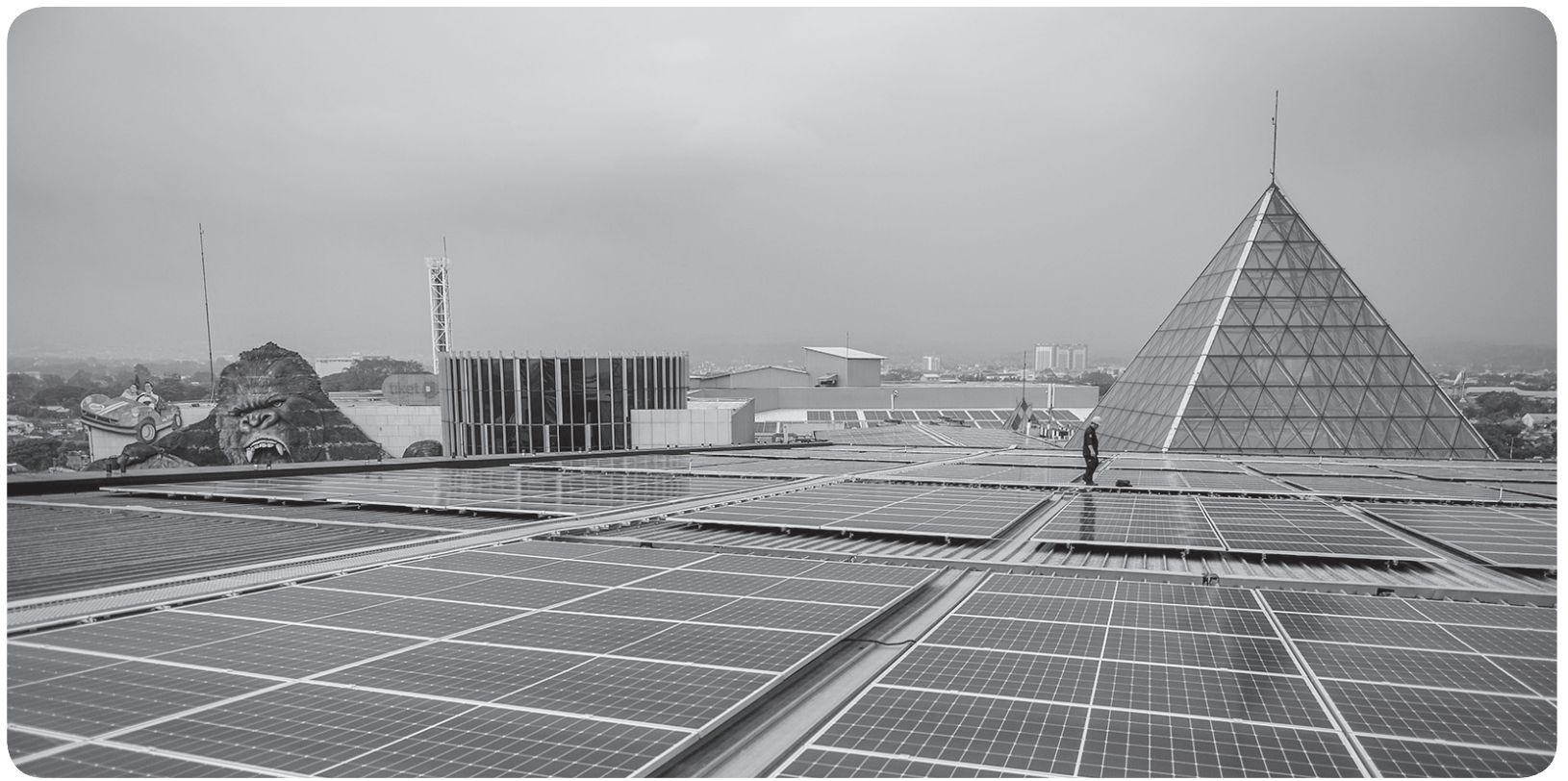
PLTS DI ATAP PUSAT PERBELANJAAN
